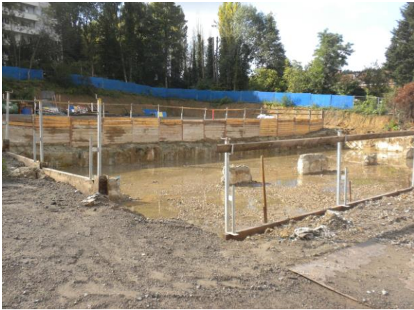
bassin d'orage du Parking Sequoia chaussée de Saint-Job
